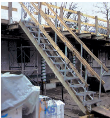
Abb. 1: Eine Bautreppe ermöglicht einen sicheren Auf- und Abgang und ist einer Leiter zu bevorzugen (Quelle: Altrad Baumann)
