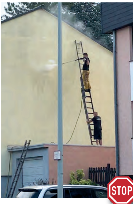
Abb. 2: So nicht! (Quelle: Dirk Oehme, BG BAU)
